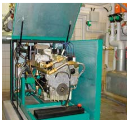
So sieht das Blockheizkraftwerk aus, das die Jenaer Ostschule mit Strom und Wärme versorgt.
