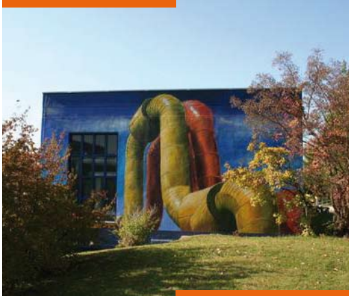
Neuer Blickfang Fernwärmestation.
