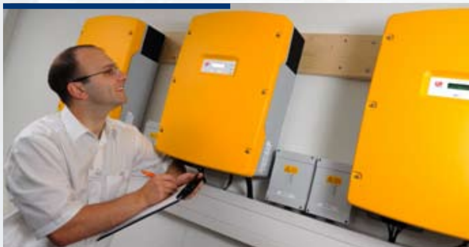
Steffen Hertwig liest die Wechselzähler ab, die anzeigen, wieviel Strom aus der Photovoltaikanlage auf dem Stadtwerke-Dach gerade ins Netz eingespeist wird.
